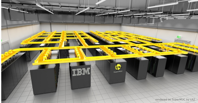
Höchstleistungsrechner SuperMUC im Rechnerraum des LRZ
